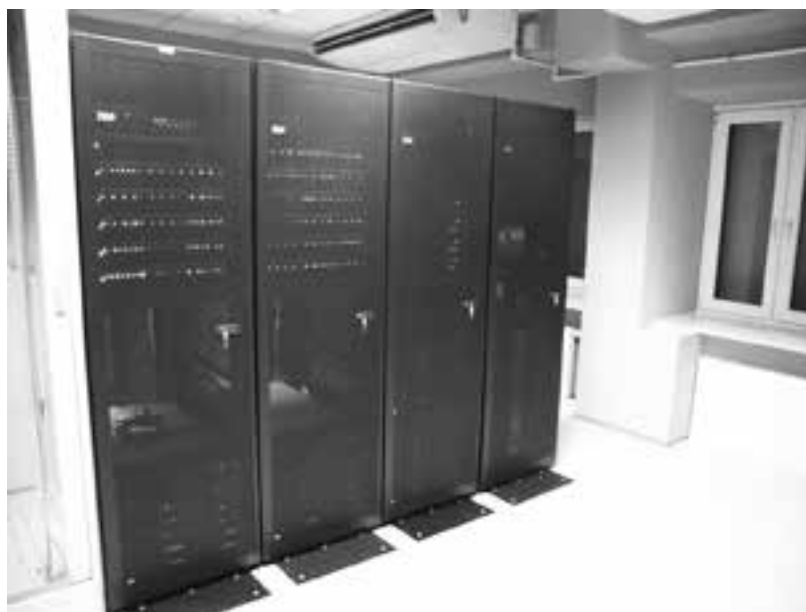
Rysunek 2. Serwerownia z urządzeniami do obsługi chmury obliczeniowej oraz Laboratorium inżynierii systemów informatycznych
