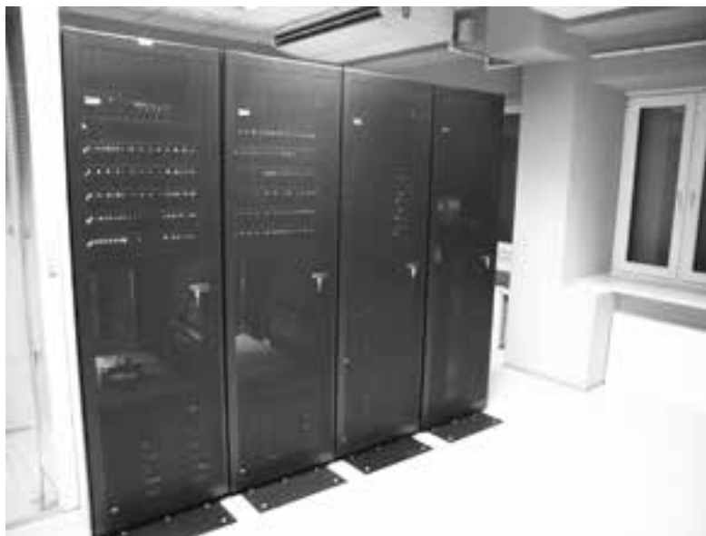
Rysunek 1. Serwerownia – sprzęt komputerowy do obsługi chmury obliczeniowej, chmury projektowej, wirtualnych desktopów oraz systemu kopii zapasowych
