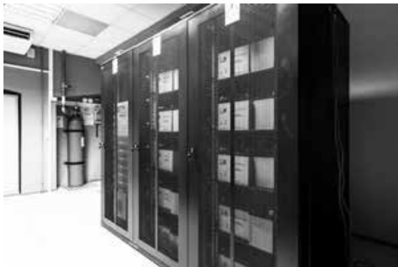
Rysunek 2. Serwerownia – system podtrzymywania zasilania, system gaszenia oraz system chłodzenia.
